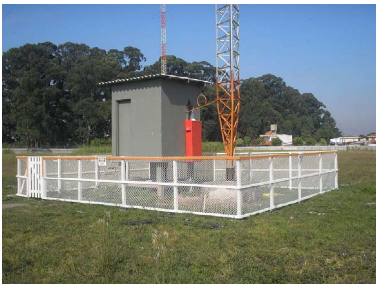
Foto 7 - Casa de Sintonia e Base da Torres
