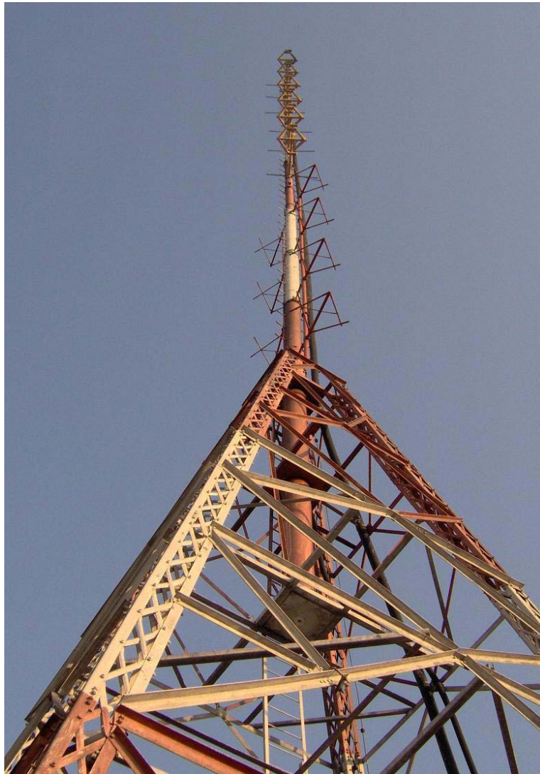
Foto 16 – Torre e antenna
