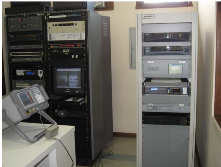
Foto 12 – Excitador digital e equipamentos de Link, Telemetria e Monitoração
