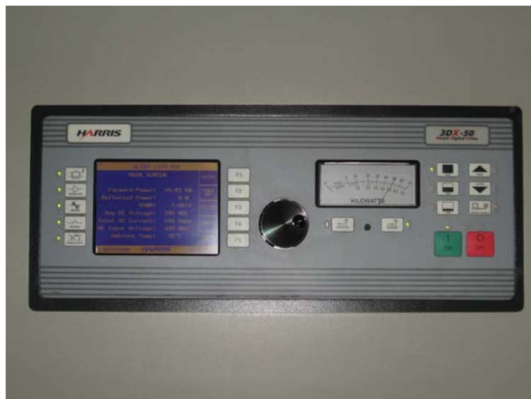
Foto 11 - Painel de Controle
