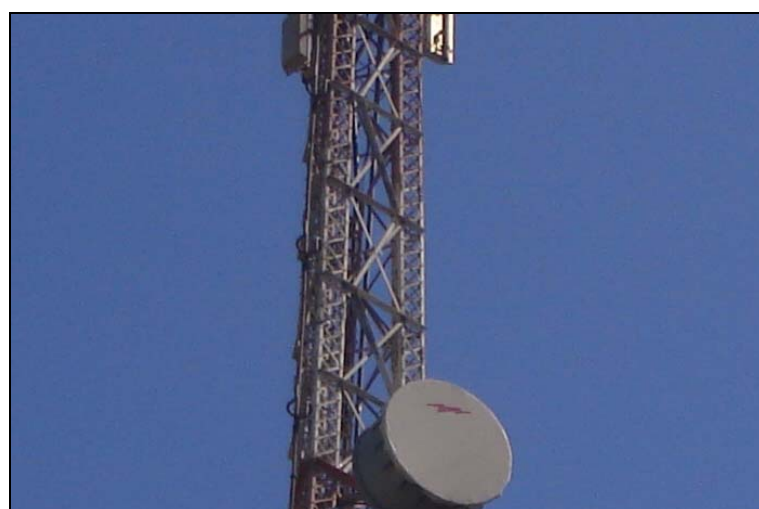
Foto 20 - Detalhe da antena digital no lado da torre
